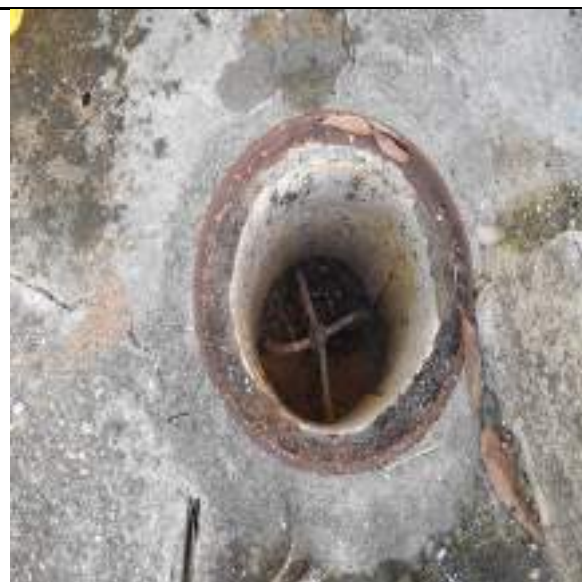
Vista caixa de inspeção e malha de aterramento.
