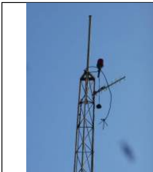
Vista do topo da torre, pararaio e base relé fotoelétrico caídos, sem o relé.
