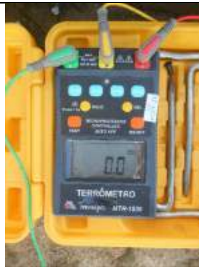
Valor de tensão elétrica encontrado em campo, 0,0V.
