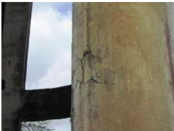
Figura 57 – Detalhe da zona superior do P3 com deslocamento do concreto em decorrência da corrosão da armadura
