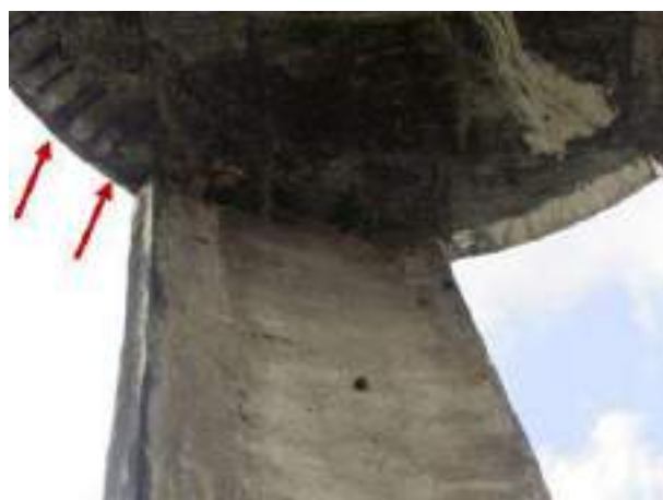
Figura 20 – Vista da laje inferior da cuba do reservatório com corrosão da armadura na borda (seta)
