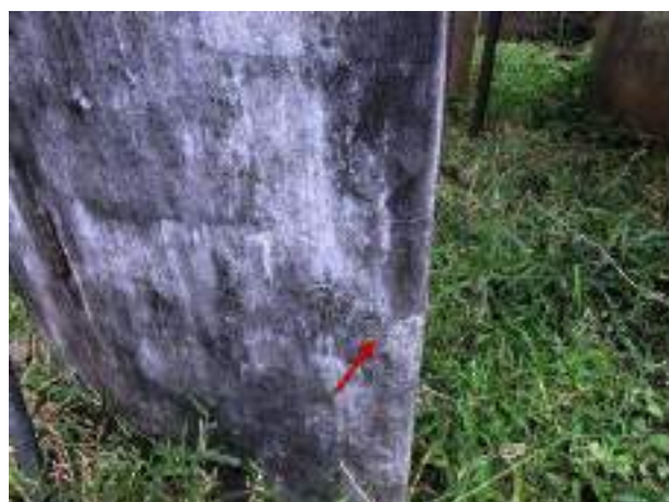
Figura 48 – Detalhe da zona inferior do P5 trincada (seta)
