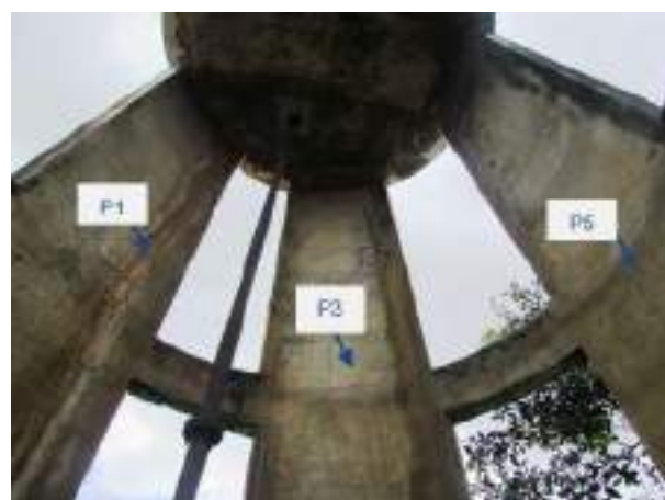
Figura 24 – Vista do anel de viga em dois trechos, trecho P1-P3, com deslocamento e corrosão da armadura e trecho P5-P3 com fissuras e manchas de umidade
