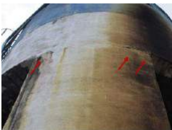
Figura 55 – Vista da zona superior do P3 com apontamento para trincas na ligação Pilar-Cuba
