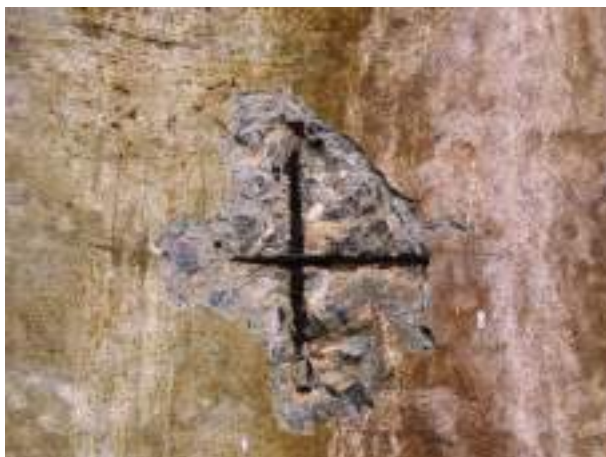
Figura 33 – Detalhe da zona com corrosão da armadura no P1
