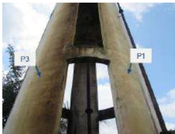
Figura 64 – Vista da continuação da mancha do produto de corrosão originada no extravasor do reservatório e apontamentos para o P1 e P3
