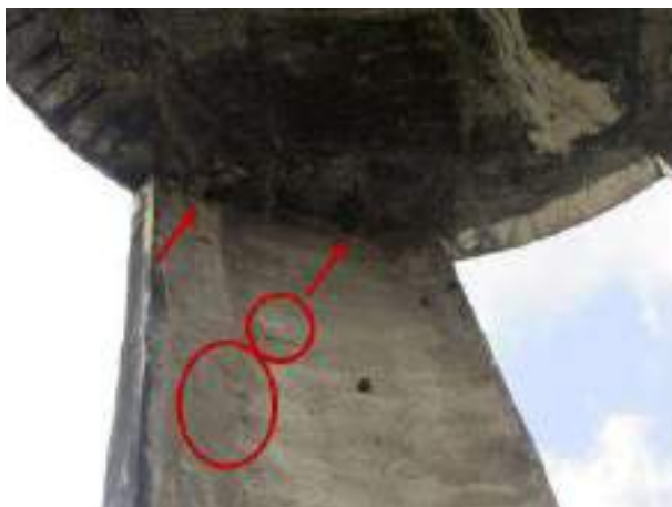
Figura 45 – Vista interna da zona superior do P4 com concreto em vista de deslocamento (círculos) e corrosão da armadura no limite com a cuba (setas)
