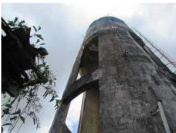
Figura 41 – Vista geral do P4 com manchas de umidade e para-raios deteriorado
