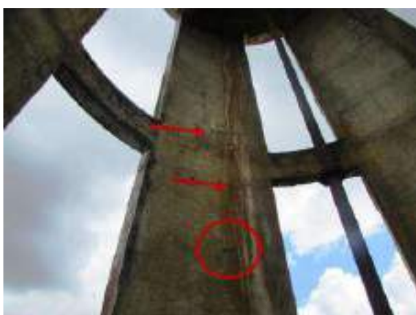
Figura 31 – Vista interna do P1 com eflorescência, concreto em vias de deslocamento (círculo) e corrosão da armadura (setas)
