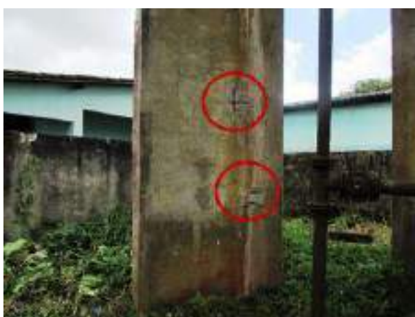
Figura 32 – Vista interna do P1 com corrosão da armadura e consequente deslocamento do concreto (destaques)
