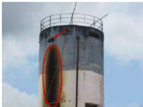
Figura 18 – Vista da cuba do reservatório com joelho (seta) gerando manchas de produto de corrosão na extensão abaixo (círculo)
