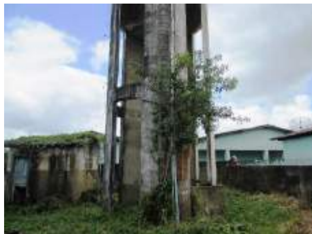
Figura 46 – Vista geral do P5 com vegetação na sua adjacência com expansão pela escada de acesso à cuba
