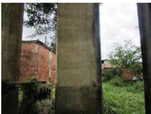
Figura 49 – Vista interna do P5 com manchas de umidade e percepção de zona com falhas de concretagem revestida por revestimento argamassado (zona mais clara)
