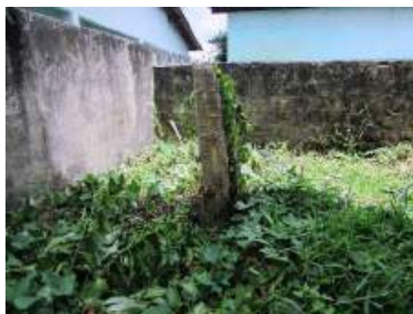
Figura 16 – Tronco de árvore de grande porte, próximo aos Pilares 1 e 2
