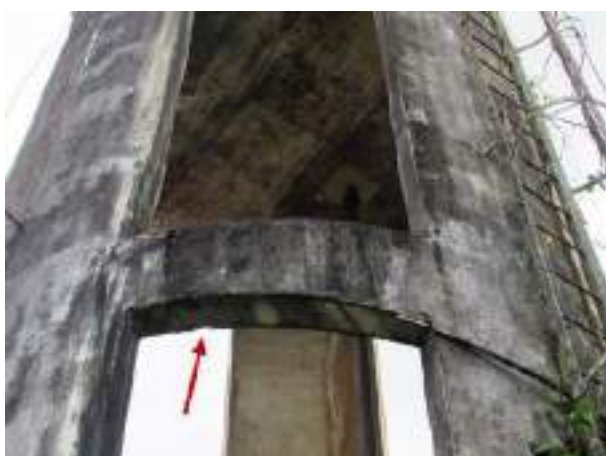
Figura 23 – Vista do anel de viga fissurado nas ligações com os P4-P5 e deslocamento do concreto (seta)
