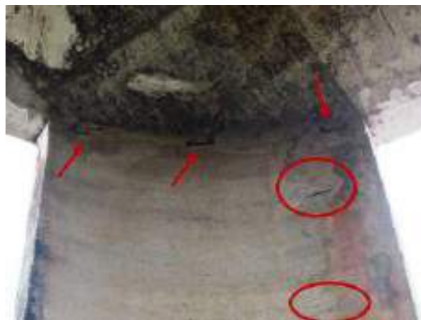
Figura 40 – Vista interna da zona superior do P2 com concreto em vista de deslocamento (círculo) e corrosão da armadura no limite com a cuba (setas)
