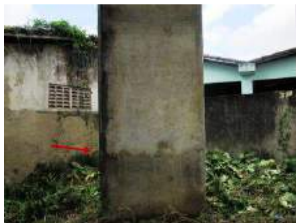
Figura 38 – Vista interna do P2 com manchas de umidade e percepção de zona com falhas de concretagem revestida por revestimento argamassado (zona mais clara, com início apontado por seta)
