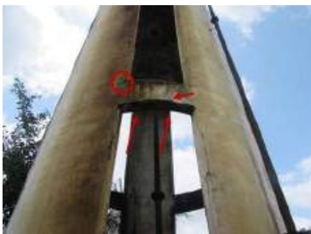
Figura 25 – Vista do anel de viga com fissuras e deslocamento na ligação com os P3-P1 (círculo) e deslocamento do concreto (setas)
