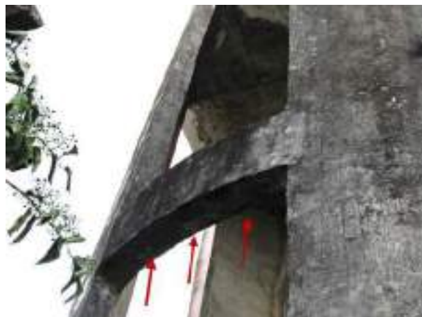
Figura 28 – Vista do anel de viga no trecho entre os P2-P4, com deslocamento do concreto e corrosão da armadura (setas)
