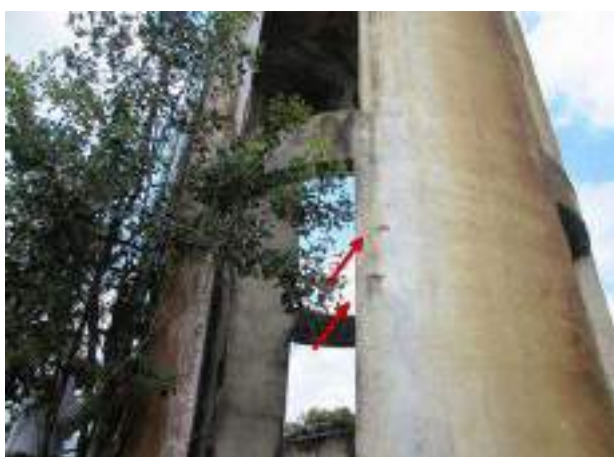
Figura 53 – Vista geral do P3 com apontamento para corrosão da armadura
