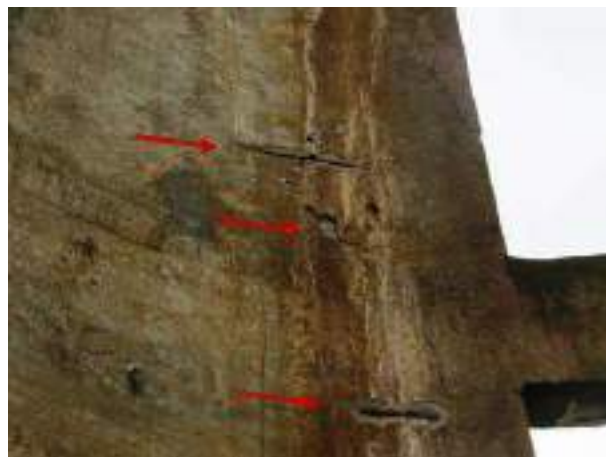
Figura 34 – Detalhe da zona superior interna do P1 com corrosão da armadura (setas) e consequente deslocamento do concreto
