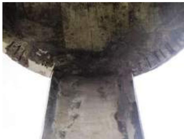
Figura 22 – Vista da laje inferior da cuba do reservatório com corrosão da armadura na borda
