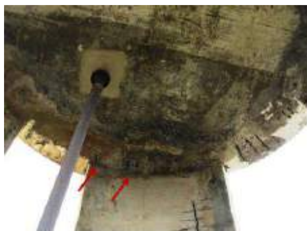
Figura 62 – Vista interna superior do P3 com apontamento para corrosão da armadura no limite entre Pilar-Cuba
