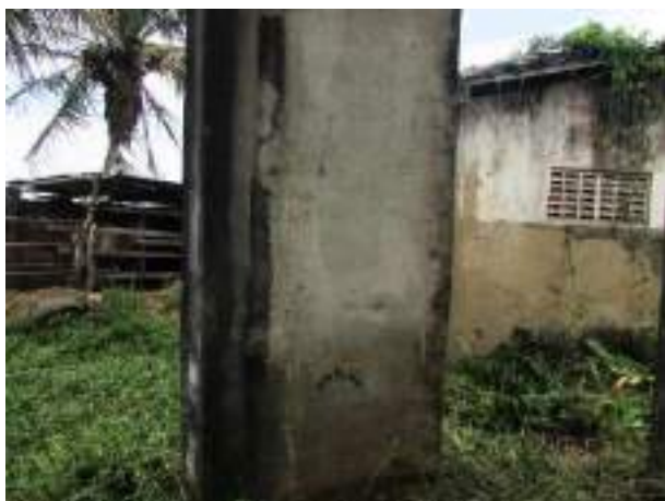
Figura 43 – Vista geral interna do P4 com manchas de umidade
