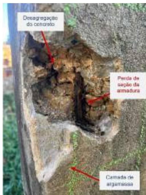
Figura 65 – Peça fraturada para ensaio de potencial de corrosão
