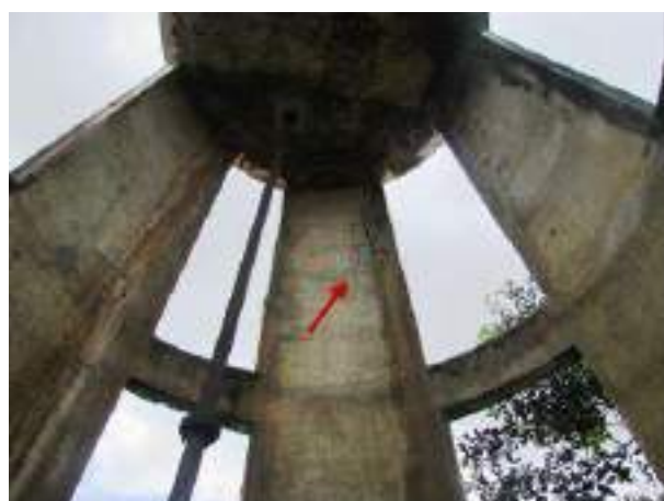
Figura 60 – Vista interna geral do P3 com manchas com apontamento para corrosão da armadura
