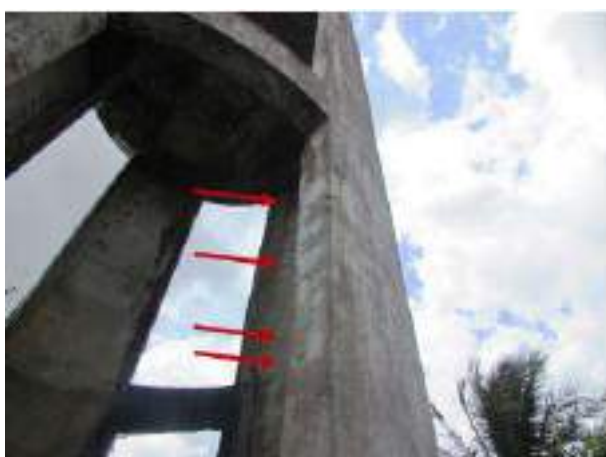
Figura 37 – Vista do P2 com zonas trincadas (setas)
