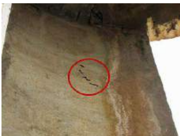
Figura 35 – Detalhe da zona superior interna do P1 com concreto em vias de deslocamento (destaque) e eflorescência
