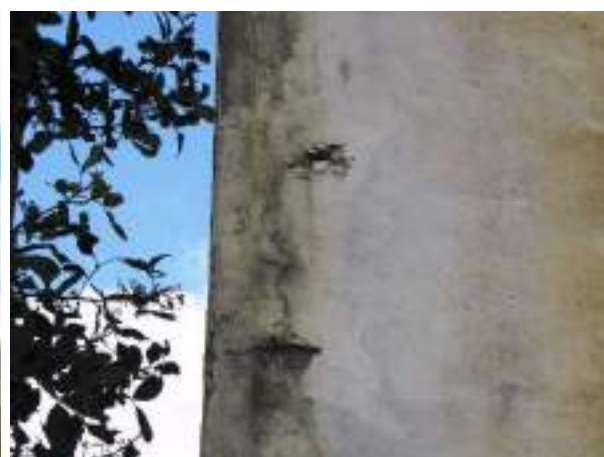
Figura 54 – Detalhe da corrosão da armadura no P3, mencionada na Figura 53
