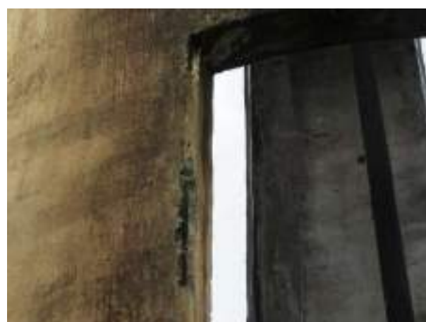
Figura 56 – Detalhe da zona intermediária do P3 com registro de corrosão da armadura e consequente deslocamento do concreto
