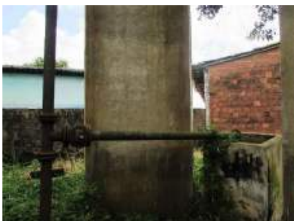
Figura 59 – Vista interna inferior do P3 com manchas de umidade
