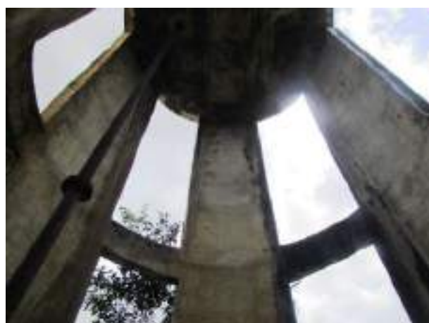
Figura 50 – Vista geral interna do P5 com manchas de umidade
