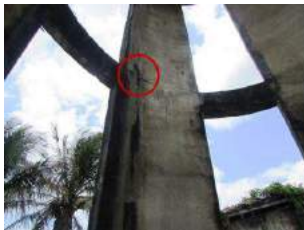
Figura 44 – Vista geral interna do P4 com manchas de umidade, eflorescência e concreto em vias de deslocamento (destaque)
