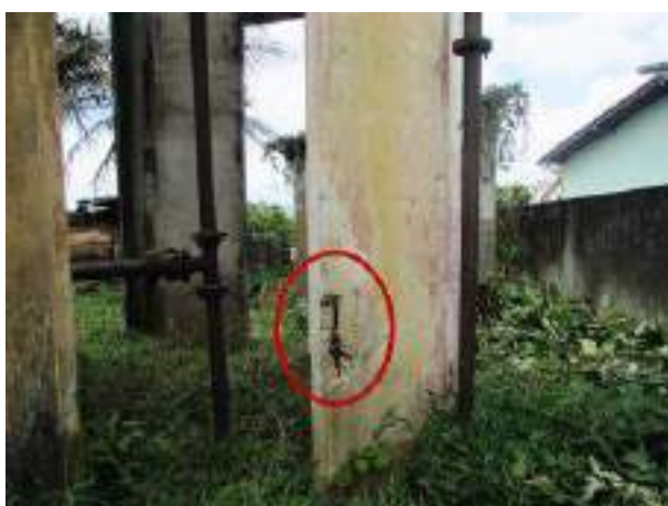
Figura 29 – Vista do P1 com corrosão da armadura e consequente deslocamento do concreto (destaque)
