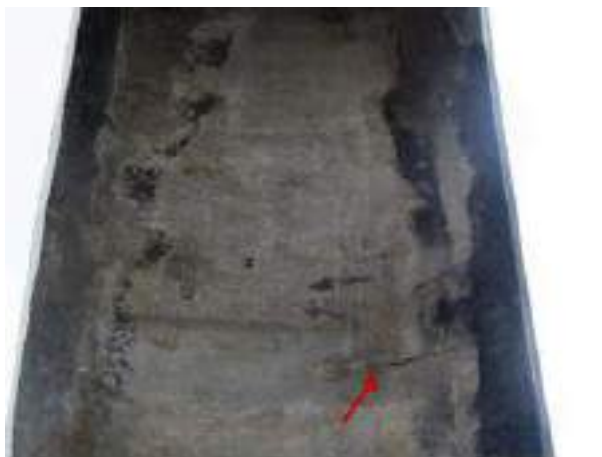
Figura 51 – Vista da zona superior interna do P5 com destaque para deslocamento do revestimento argamassado
