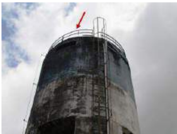
Figura 17 – Vista geral da cuba, com presença de limo, escada de acesso degradada e guarda-corpo deteriorado (seta)
