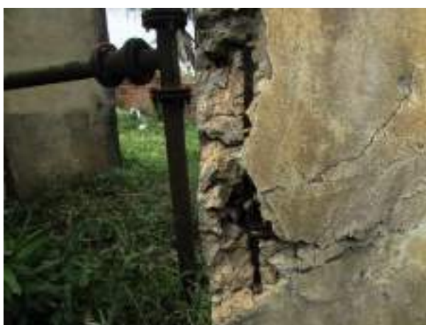
Figura 30 – Detalhe da zona com corrosão da armadura no P1 e registro do cobrimento com espessura substancial
