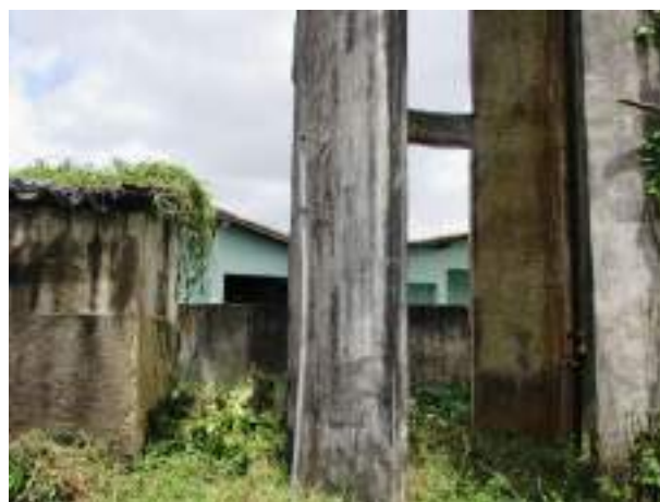
Figura 42 – Vista geral do P4 com manchas de umidade e para-raios deteriorado
