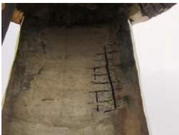
Figura 61 – Detalhe da corrosão da armadura mencionada na Figura 60
