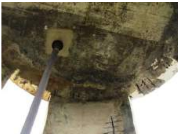
Figura 21 – Vista da laje inferior da cuba do reservatório com corrosão da armadura na borda
