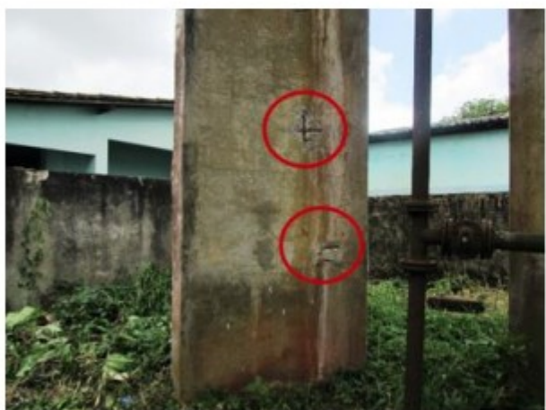
Figura 10 – Vista interna do P1 com corrosão da armadura e consequente deslocamento do concreto (destaques)
