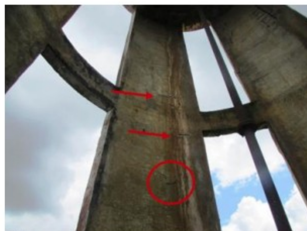
Figura 9 – Vista interna do P1 com eflorescência, concreto em vias de deslocamento (círculo) e corrosão da armadura (setas)
