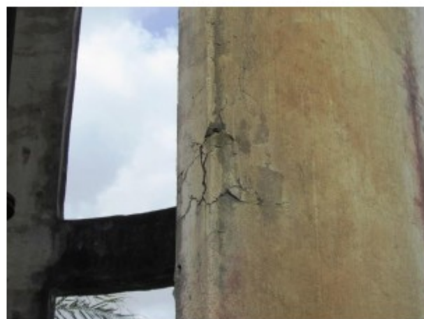
Figura 11 – Detalhe da zona superior do P3 com deslocamento do concreto em decorrência da corrosão da armadura
