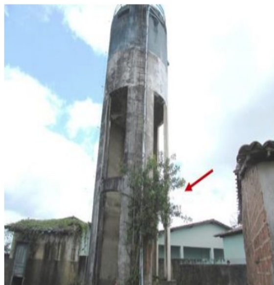
Figura 5 – Vista geral do reservatório com apontamento para vegetação próxima ao Pilar 5 e escada de acesso
