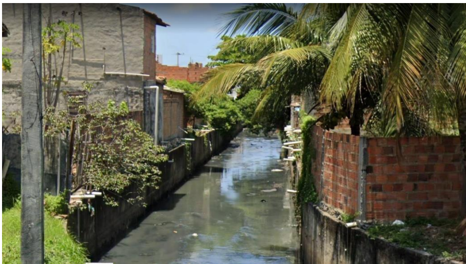
Figura 36 - Trecho de canal recebendo contribuições de esgotos domésticos na rua Major Combiniano no bairro Santos Dumont, com posterior deságue no Riacho Cabral.
