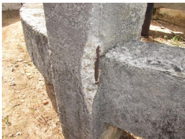
Figura 13 – Elevado nível de deterioração dos pilares com corrosão das armaduras e deslocamento do concreto de cobrimento.
