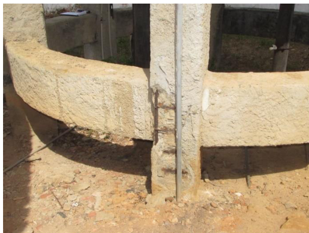
Figura 11 – Elevado nível de deterioração dos pilares com corrosão das armaduras e deslocamento do concreto de cobrimento.
