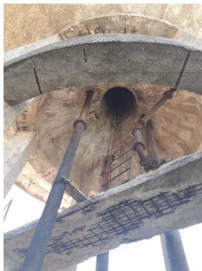
Figura 58 – Situação de escada e patamar de entrada na cuba do reservatório.
