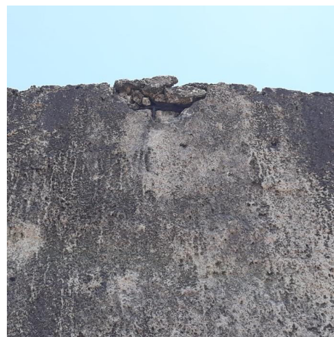
Figura 20 – Parede do reservatório com deslocamento do concreto e armadura exposta.
