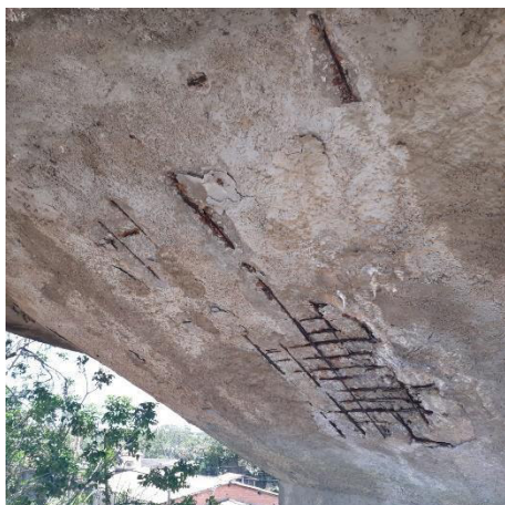
Figura 17 – Elevado nível de deterioração das paredes da cuba (corrosão das armaduras, deslocamento do concreto e eflorescência)
