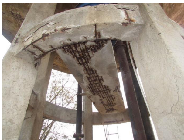
Figura 9 – Elevado nível de deterioração com corrosão das armaduras e deslocamento do concreto de cobrimento.
