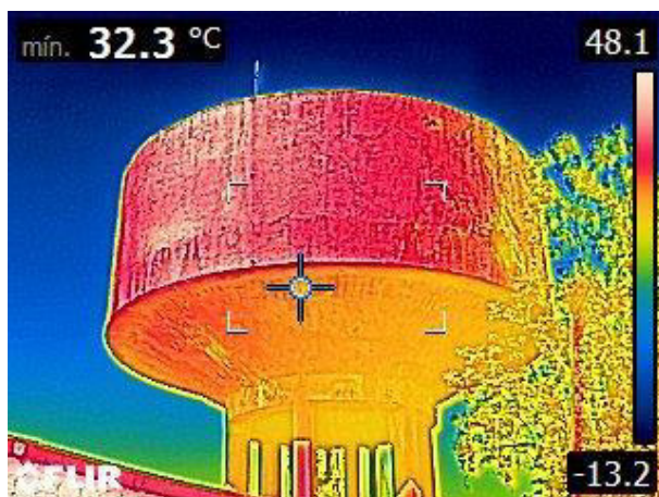
Figura 41 – Ensaio de termografia executado na parede da cuba com visualização de pontos de umidade e vazamento.
