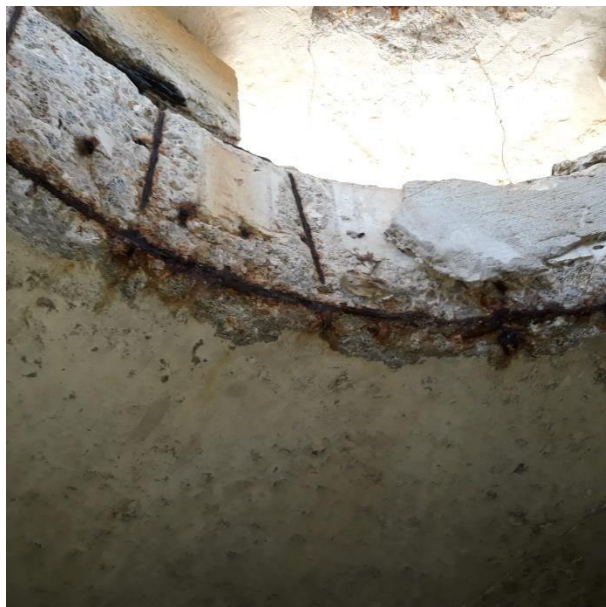
Figura 23 – Estrutura interna da cuba com armaduras expostas e processo de corrosão instalado.
