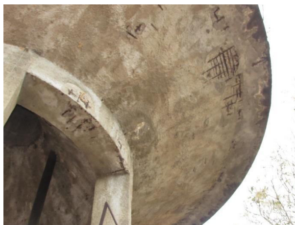
Figura 16 – Elevado nível de deterioração das paredes da cuba com corrosão das armaduras e deslocamento do concreto de cobrimento.
