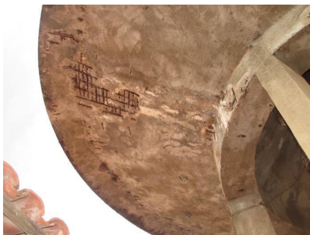
Figura 15 – Elevado nível de deterioração das paredes da cuba com corrosão das armaduras e deslocamento do concreto de cobrimento.
