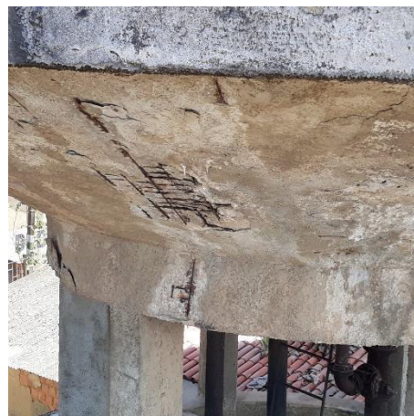
Figura 18 – Elevado nível de deterioração das paredes da cuba (corrosão das armaduras, deslocamento do concreto e eflorescência)
