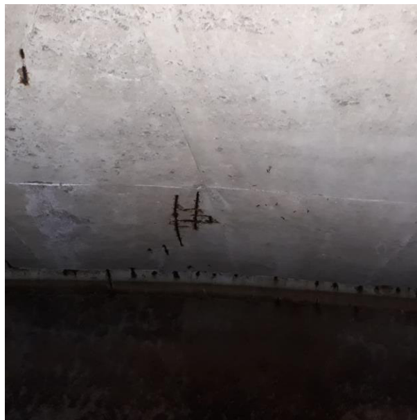
Figura 24 – Laje interna da cuba com armaduras expostas e processo de corrosão instalado.
