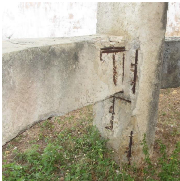
Figura 50 – Pilar com corrosão avançada na base
