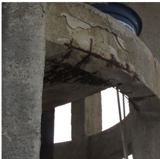
Figura 49 – Viga com corrosão avançada
