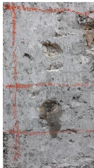
Figura 36 – Resultado do ensaio de presença de cloretos na base do pilar P6.
