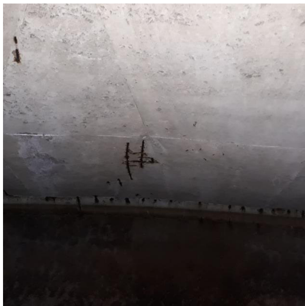
Figura 51 – Laje com armaduras expostas.
