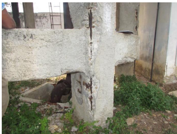
Figura 7 – Processo de corrosão instalado no pilar.
