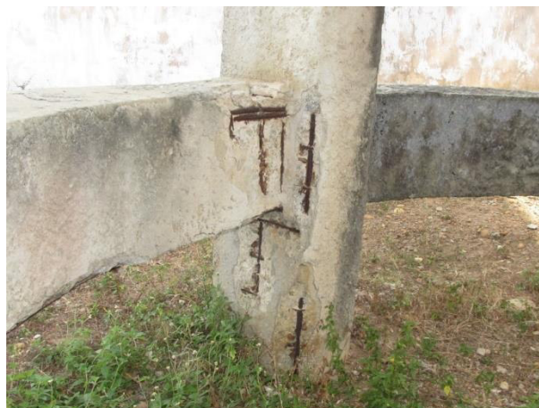
Figura 12 – Elevado nível de deterioração dos pilares com corrosão das armaduras e deslocamento do concreto de cobrimento.
