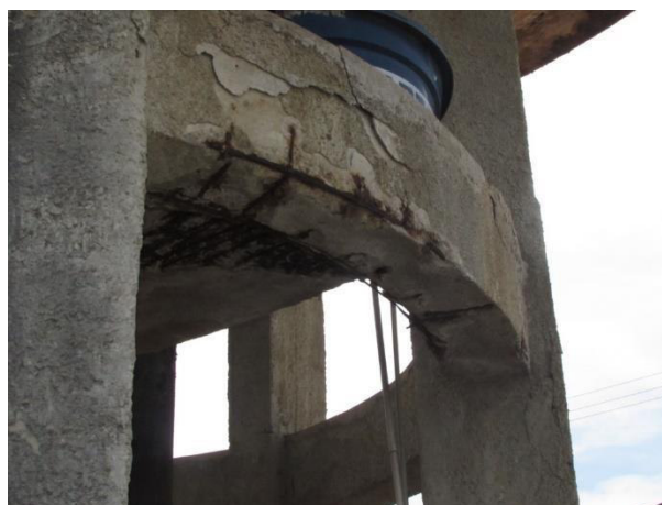
Figura 10 – Elevado nível de deterioração das vigas com corrosão das armaduras e deslocamento do concreto de cobrimento.
