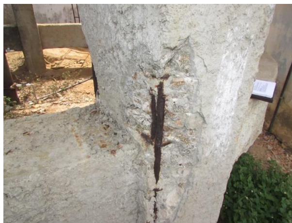
Figura 8 – Armadura exposta com processo de corrosão instalado.
