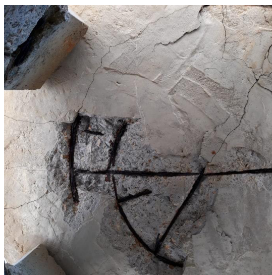
Figura 22 – Fundo da cuba com elevado processo de deterioração.
