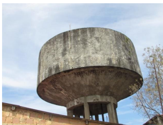
Figura 57 – Parede do reservatório com fissuras e eflorescências.
