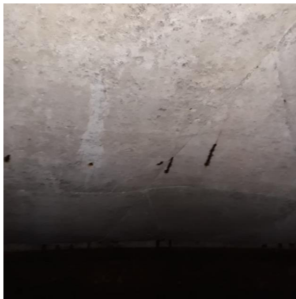
Figura 52 – Laje com armaduras expostas.
