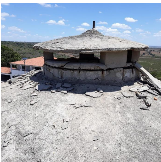
Figura 21 – Estrutura do topo da cuba com estado de deterioração crítico.
