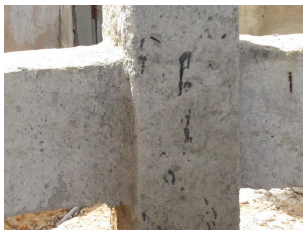
Figura 14 – Elevado nível de deterioração dos pilares com corrosão das armaduras e deslocamento do concreto de cobrimento.
