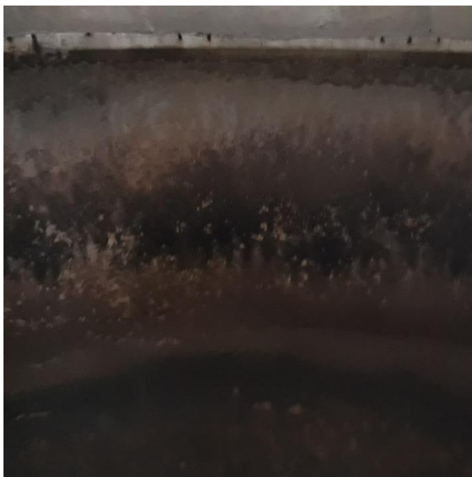
Figura 53 – Parede interna com sistema de impermeabilização com vida útil consumida.
