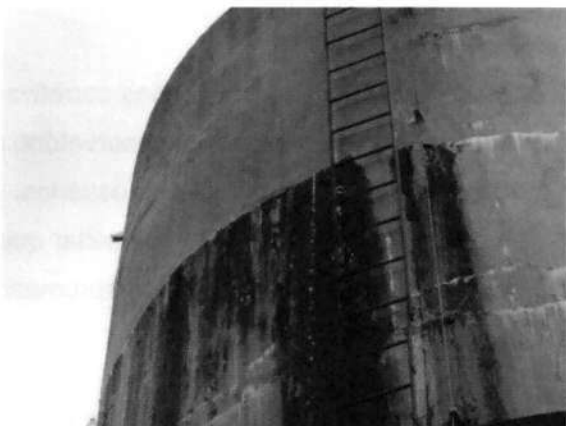
Figura 11 – Infiltração na cuba com corrosão na escada de marinha
