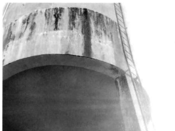
Figura 10 – Infiltração na cuba
