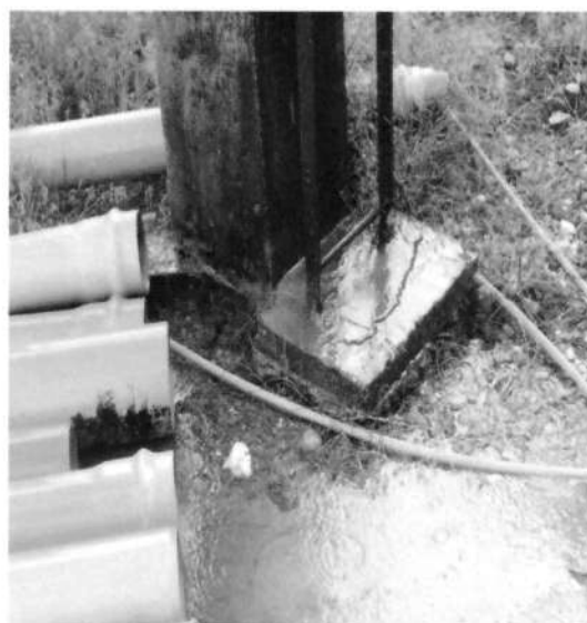
Figura 6 – Vazamento escorrendo pelo pé do pilar
