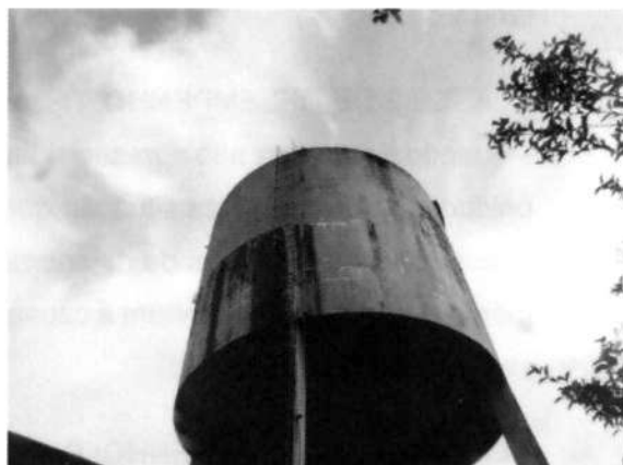
Figura 12 – Infiltração na cuba
