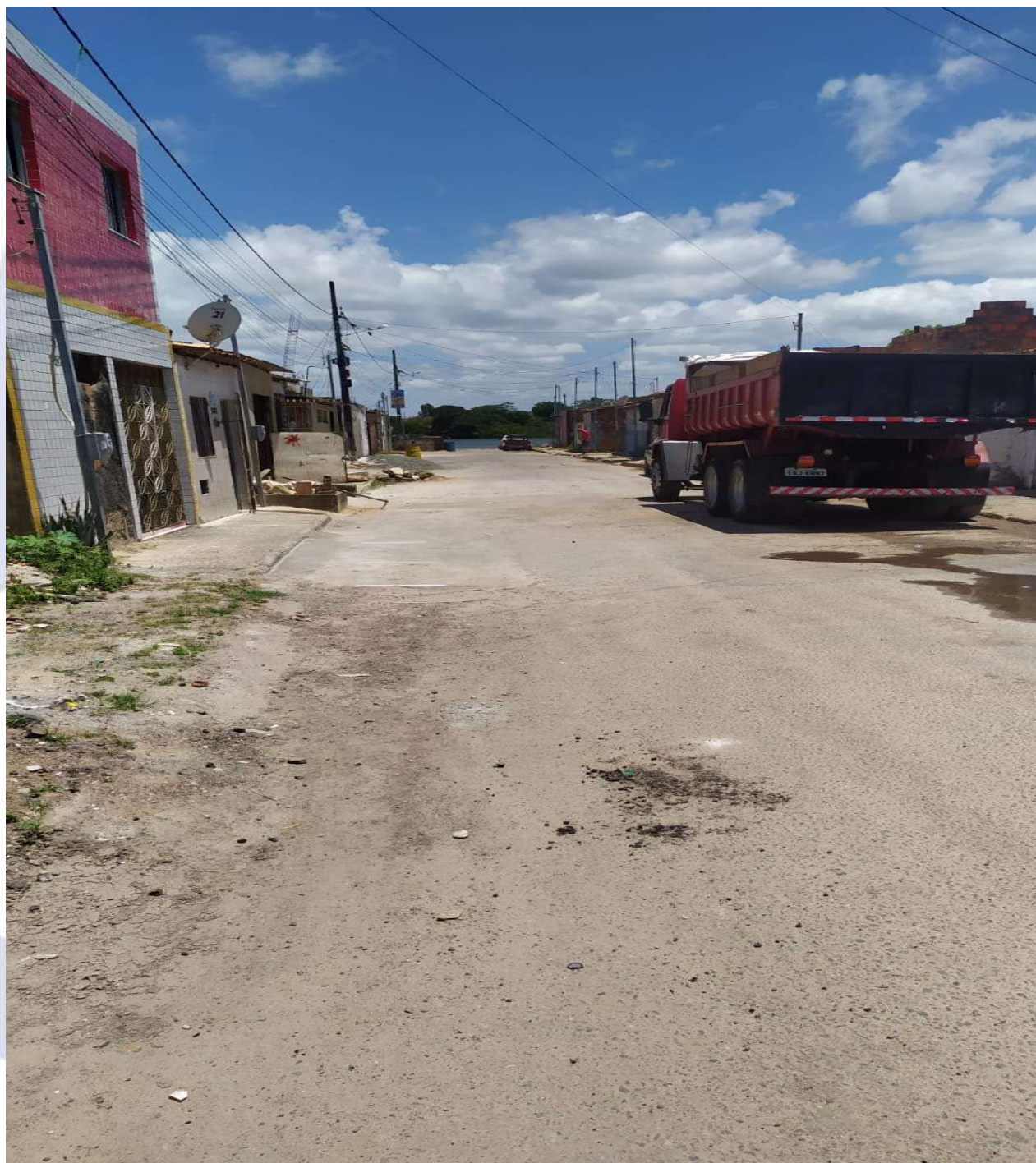
Rua Beira Rio lado esquerdo a tubulação DN 800mm Ferro Fundido
