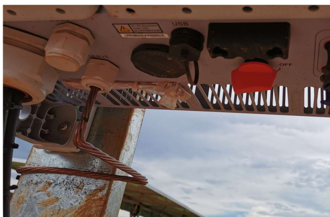
Figura 3: Seccionadora CC do inversor.
